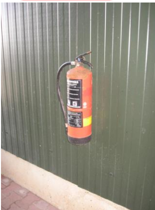
(sproei)schuimblusser op een niet vorstvrije plaats
