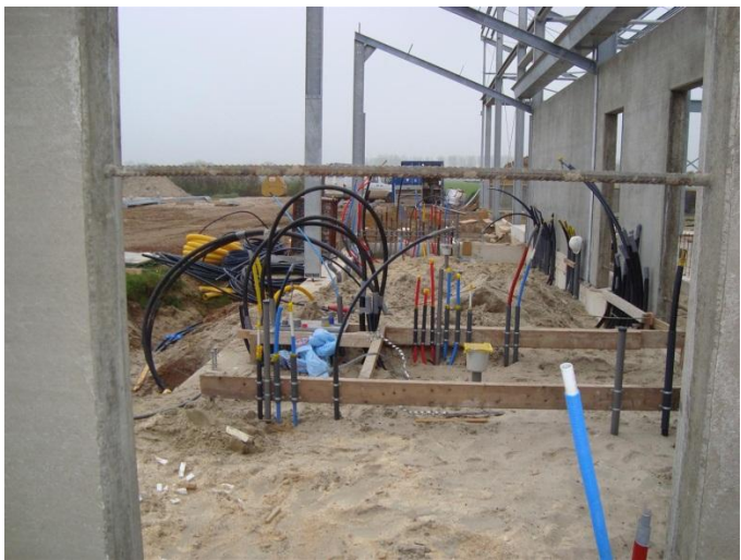
1. Leidingen verdwijnen onder de (kelderloze)vloer
